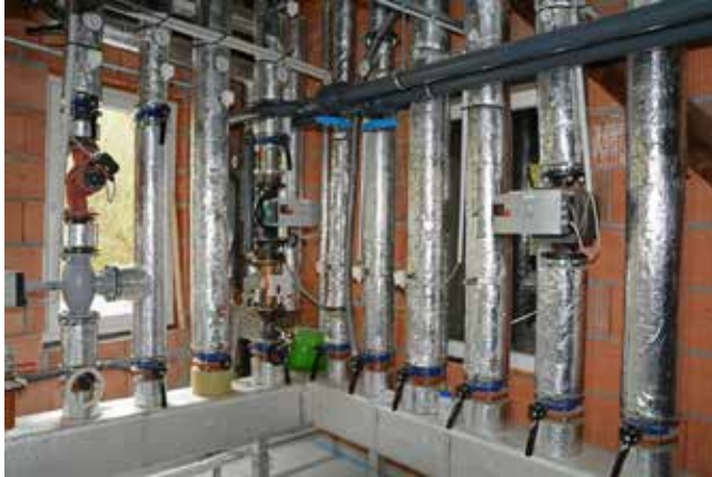
Abb. 9 Hauptverteiler Aufnahme der Wärmerückgewinnung, Verteilung auf Pufferspeicher und in die Gebäude
