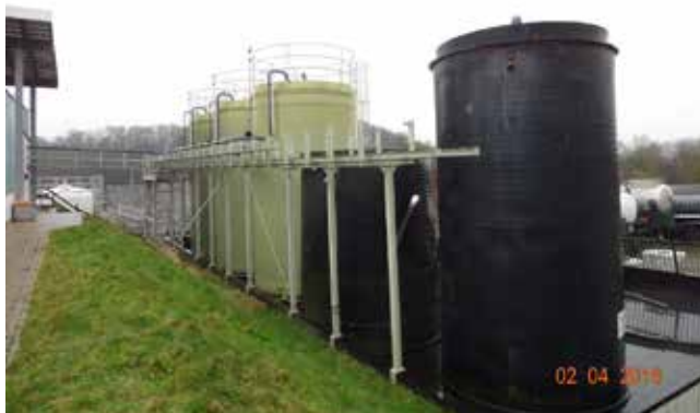
Abb. 1 Darstellung der neuen Tankanlage zur Aufnahme der vorrätig erstellten Produktsäuren
