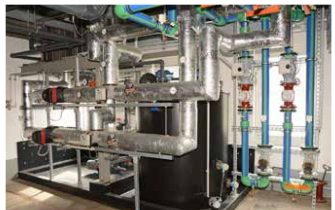
Abb. 6 Säureverstanlage im EG mit Auffangbehälter und der Hydraulik zur Wärmeübertragung im HT- (60-80 °C) und NT- Bereich (30-40 °C).
