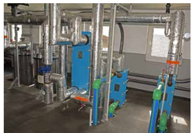
Abb. 3 & 4 Produktionswärmeübertrager mit Mischkopf zur Produktion der verschiedenen Säuremischungen; installiert im DG
